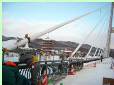
加速度計設置状況
