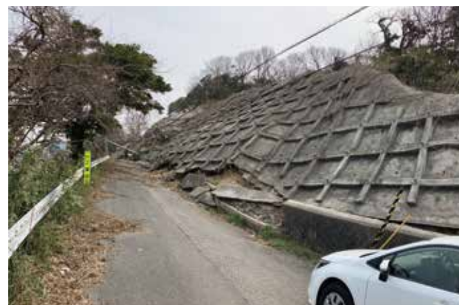
アンカー付法枠の被災状況
